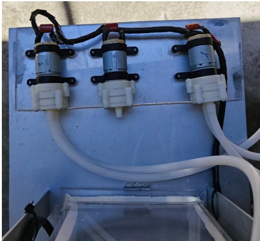
Hình 15 - Ảnh thực tế vị trí lắp đặt các bơm
