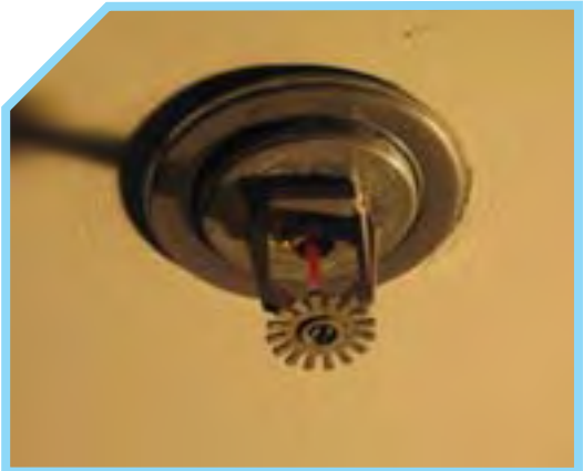
HỆ THỐNG VÒI PHUN NƯỚC 8
