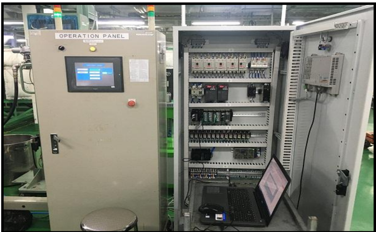
Hình 4.1 Tủ điện điều khiển lập trình PLC.
