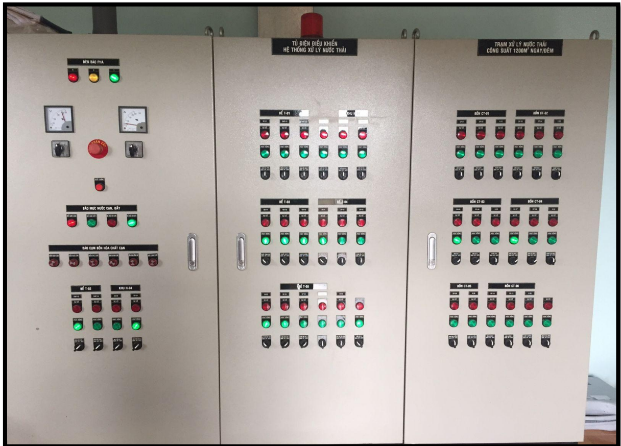
Hình 3.2.2 Tủ Điều khiển.
