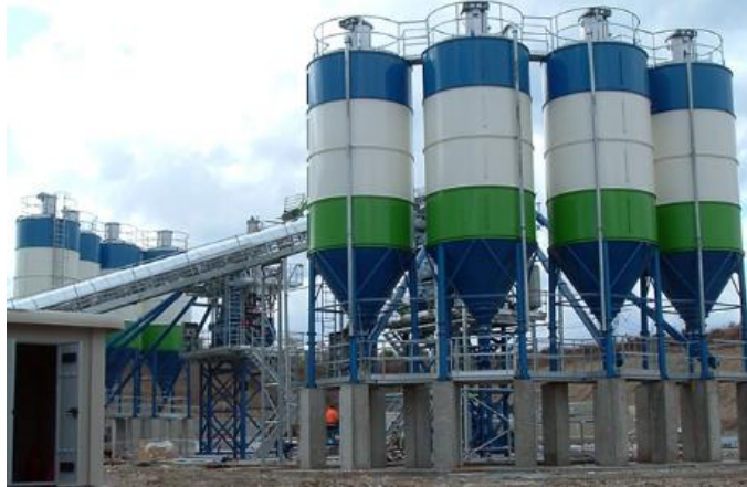
Hình 2.3: Silo xi măng ở trạm trộn bê tông
