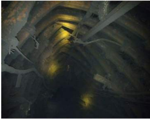
a) Đường thượng Vận tải 14.5 khu Đông Nam, Khe Chàm III bị biến dạng.
