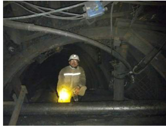
b) Đường thượng Vận tải 14.5 khu Đông Nam, Khe Chàm III bị lún nóc.
